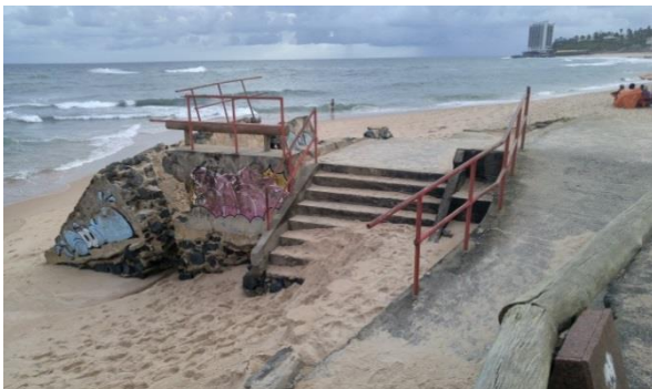
FOTO 15: comprometimento da acessibilidade.
