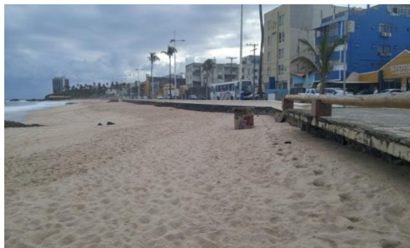
FOTO 10: calçadas em balanço comprometidas.
