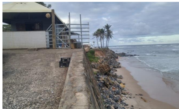
FOTO 32: danos nas contenções – Pituba.
