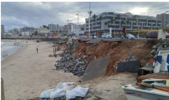
FOTO 31: danos nas contenções – Pituba.
