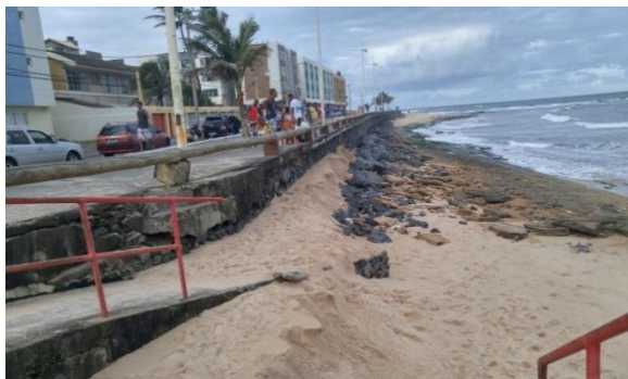
FOTO 18: comprometimento da acessibilidade.
