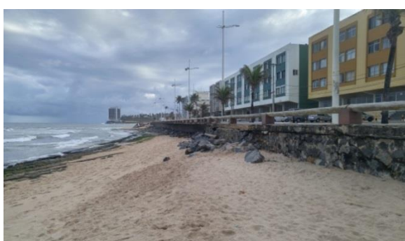
FOTO 22: alvenarias e calçadas em balanço.
