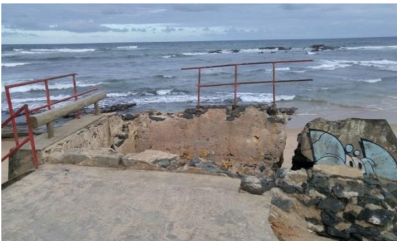
FOTO 16: comprometimento da acessibilidade.
